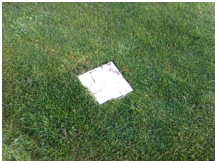
Foto 7. Detalle de las arquetas rotas en los antegreens.
