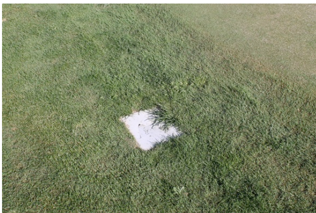
Foto 8. Detalle de las arquetas rotas en los antegreenes.
