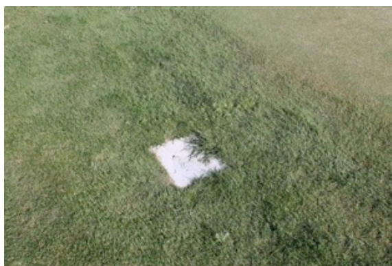
Foto 7. Detalle de las arquetas rotas en los antegreens.
