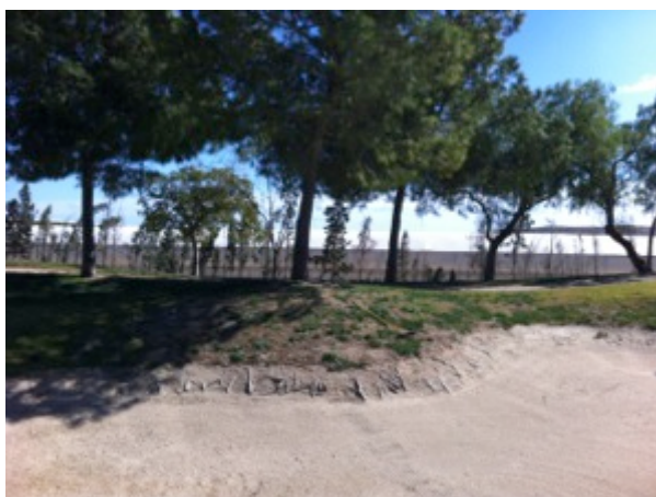
Imagen 23: Paredes de los bunkers sin arena que dejan entrever la invasión de raíces de los árboles cercanos.
