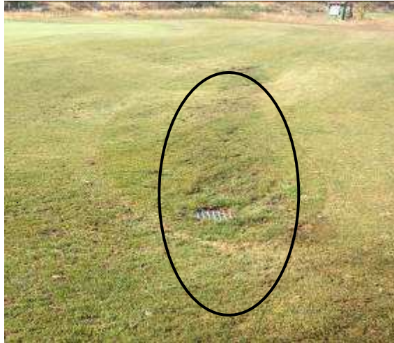
Zona encharcada con arqueta elevada
