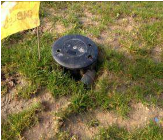
Estado de algunos aspersores
