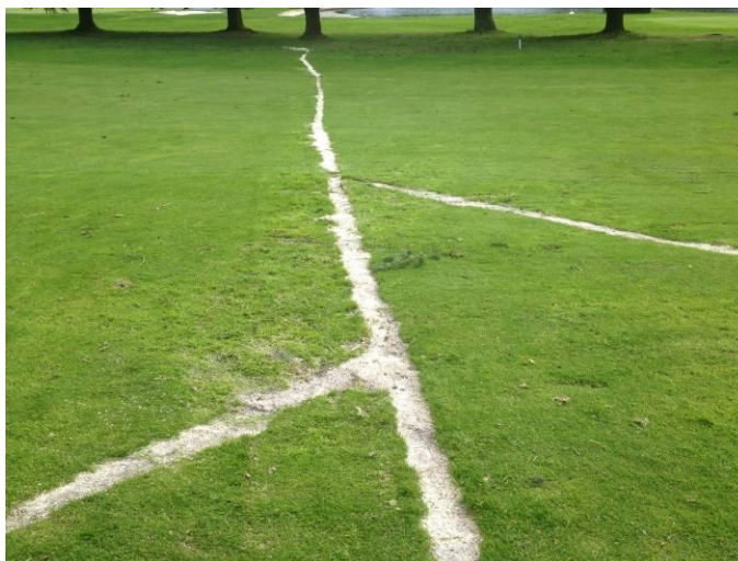
Foto 8. Drenajes en la calle del hoyo 13.
