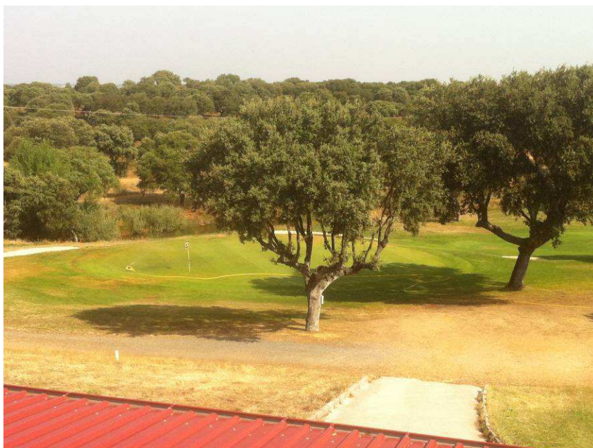
Foto 8. Riego mediante aspersores fijos.
