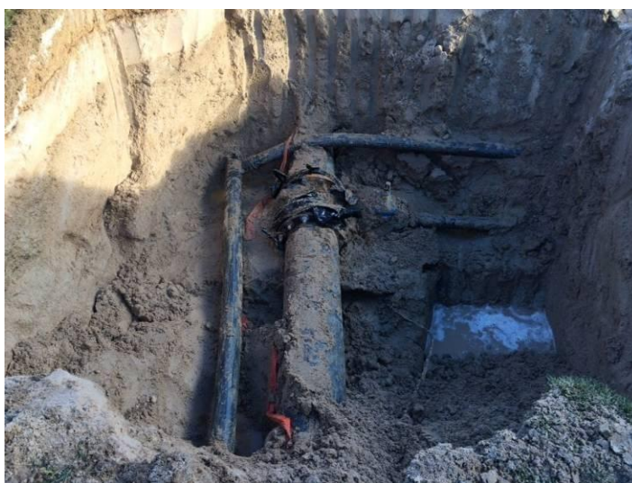
Foto 17. Avería zona del tee del hoyo 10.
