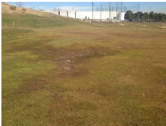
Foto 8. Zona con deficiente capacidad de infiltración de agua.
