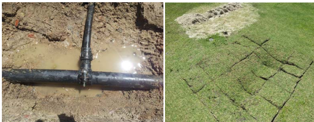
Imágenes 4 y 5. Detalle del collarín dañado, retepeado de la zona afectada.
