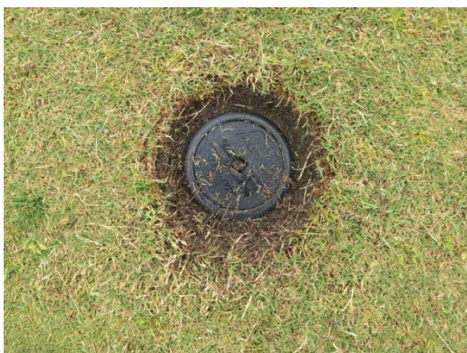
Imagen 6. Detalle de limpieza de aspersores
