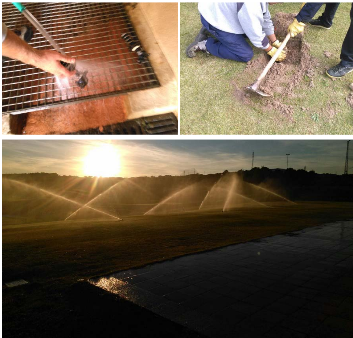
Imágenes 4 y 5. Detalle limpieza aspersor; Nivelación aspersor
