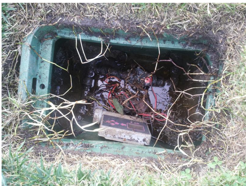
Foto 2: Estado general de las arquetas de riego.
