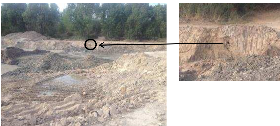
Rotura de la tubería por la construcción de un lago en la finca “La Cañalera”
