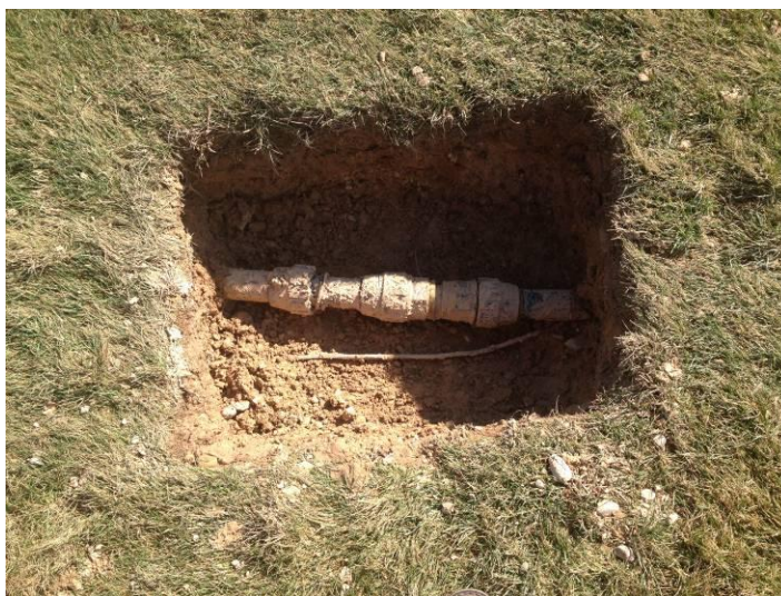
Foto 12. Avería del sistema de riego.
