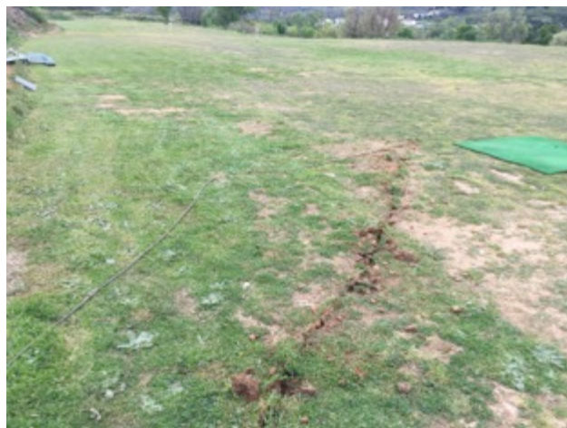
Cable eléctrico sin protección ni aislamiento enterrado y cruzando la cancha de prácticas.
