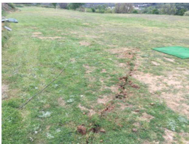
Cable eléctrico sin protección ni aislamiento enterrado y cruzando la cancha de prácticas.
