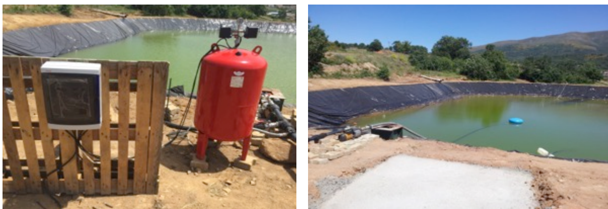
Cuadro eléctrico, calderín e instalación de bomba horizontal antigua. Losa de hormigón donde se va a construir la caseta de riego (bomba sumergida nueva y flotador en el interior de la balsa)
