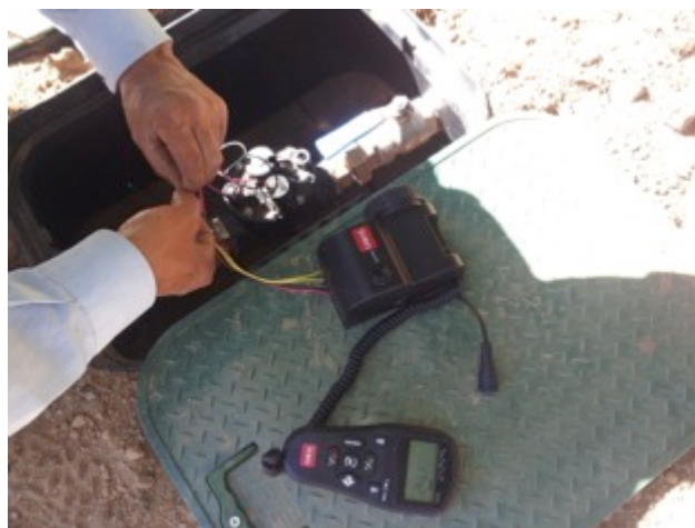
Consola para programar electroválvulas nuevas.
