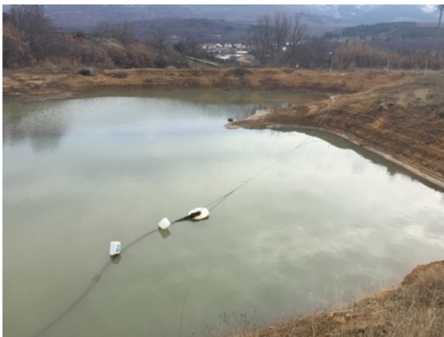
Foto 3: Balsa de riego que requiere impermeabilización.
