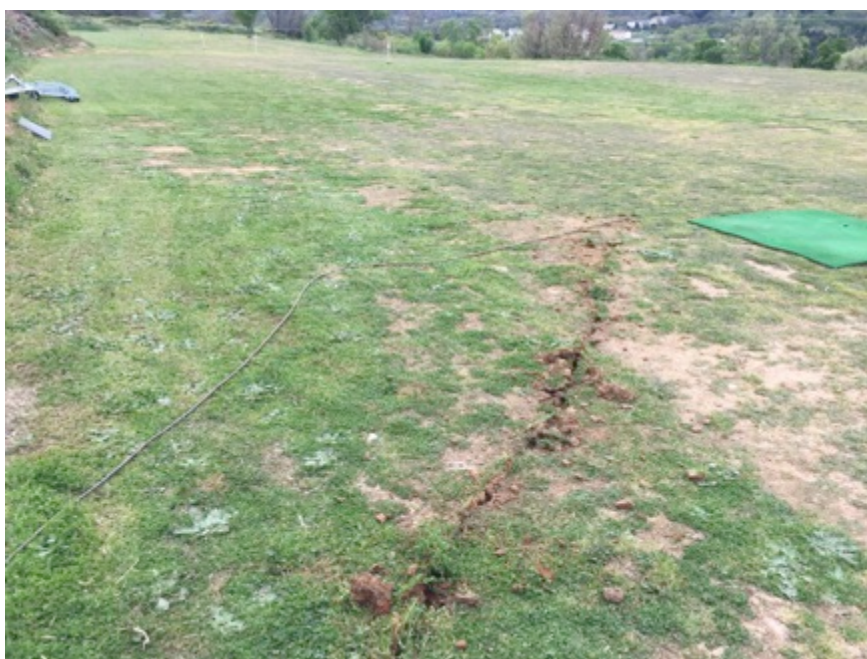
Instalación eléctrica del bombeo antiguo enterrada sin protección a través de la cancha de prácticas.
