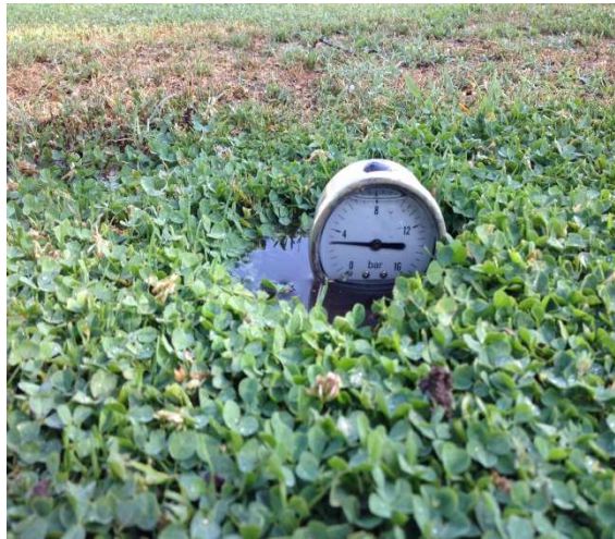
Manómetro de presión roscable en carcasa de aspersor.
