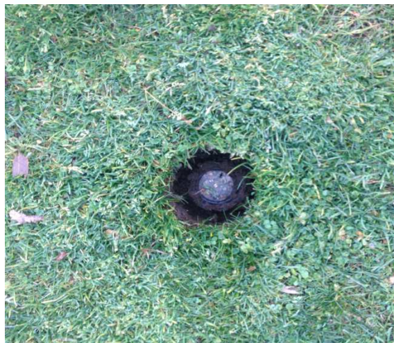
Limpieza de aspersores
