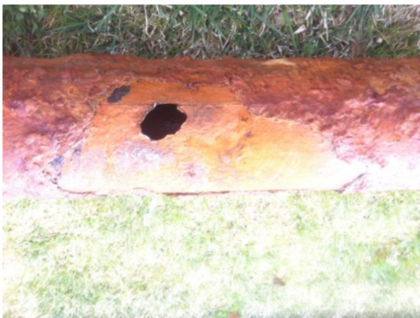
Foto 12: Rotura en el tubo de perforación del pozo, completamente corroída.
