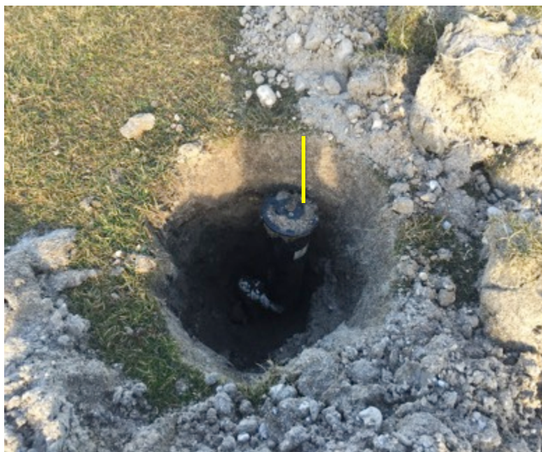
Foto 1: Detalle de la profundidad a la que se encontraba este aspersor que necesitaba nivelarse.
