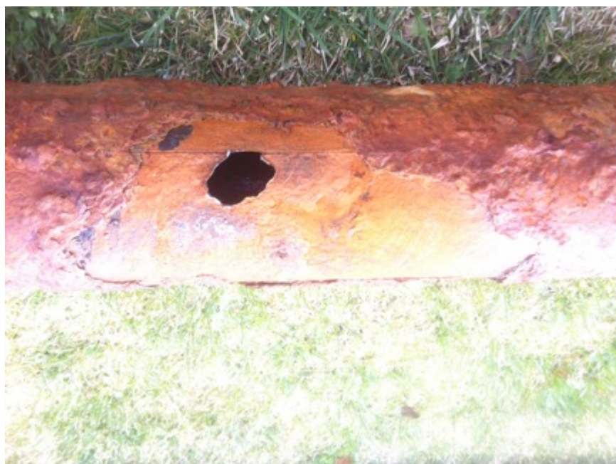
Imagen 1 :Rotura en la tubería de captación del pozo.
