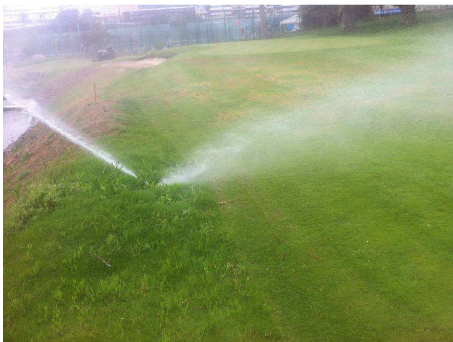
Foto 8. Trayectoria del chorro deficiente.
