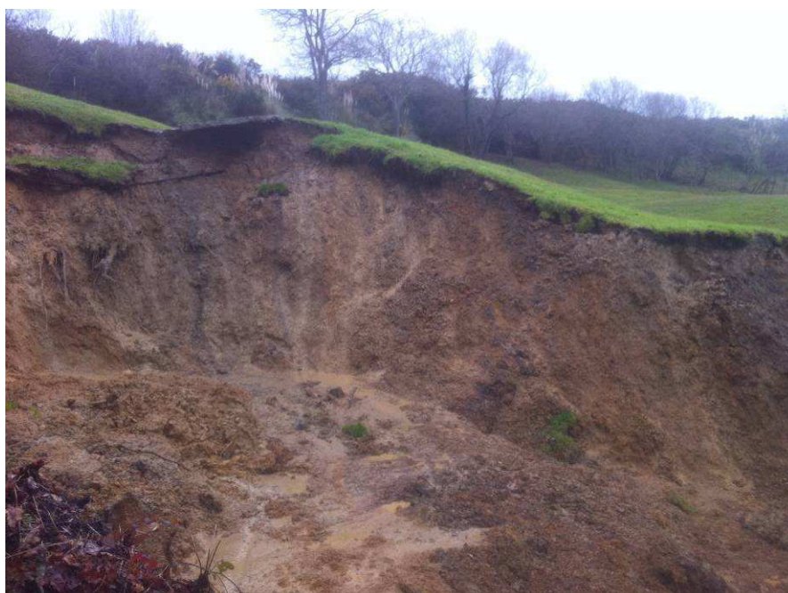
Foto 3. Corrimiento de tierras en tee #10.
