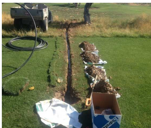
Nuevo aspersor de apoyo calle 4
