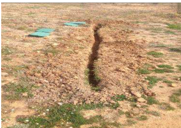
Incorporación de un nuevo aspersor calle 5
