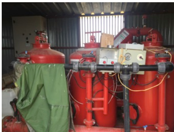
Imagen 18: Sistema de filtrado que no se usa.
