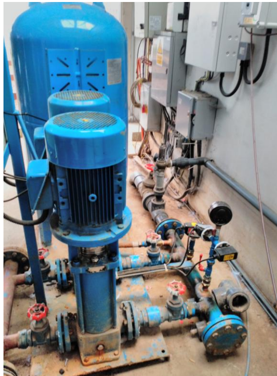
Estación de bombeo de Elmwood Golf Club.
